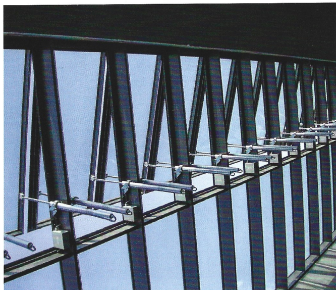
Entrauchung über Fassadenfenster.
