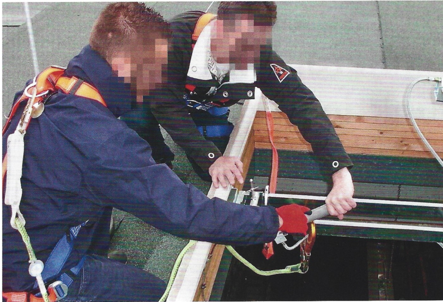
Die Projektierung und Montage der Brandschutzsysteme übernehmen häufig Dachdecker, Elektriker, Lüftungsbauer oder Brandschutzbetriebe.
