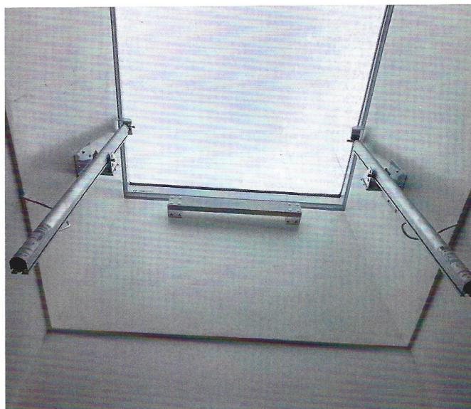
Entrauchung über Dachkuppeln.
